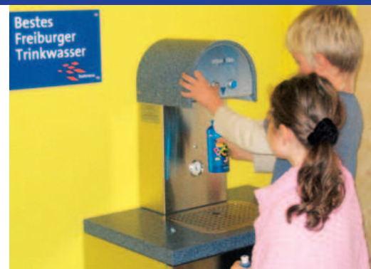
Test bestanden: die Tafelwasseranlage der Paul-Hindemith-Schule in Freiburg
